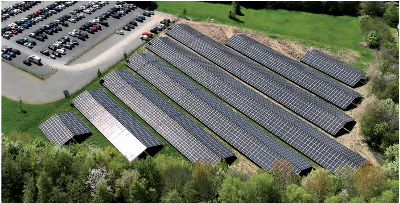
Der firmeneigene Solarpark am Hauptstandort Höxter ist mit ca. 3.400 Module ausgestattet und erreicht eine Leistung von bis zu 1,4 Megawatt.
